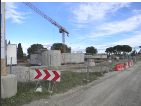
Station d'épuration intercommunale
